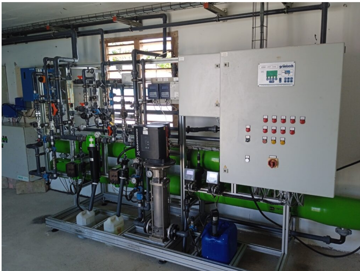
Planta potabilizadora en Cayo Ramona
